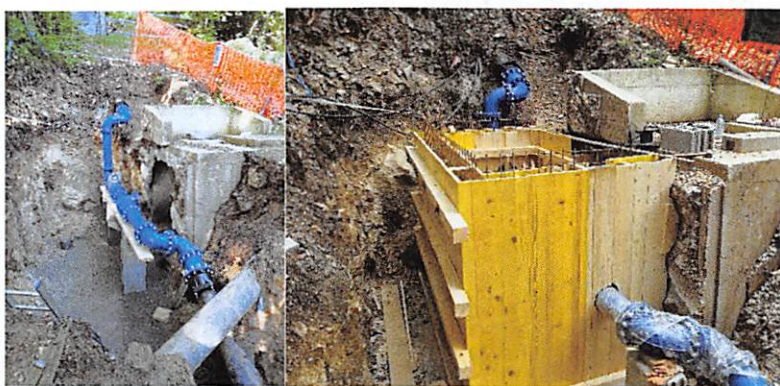
Slika 15: Izvedba jaška na VH Čatež
