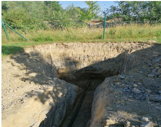
Slika 10: Tlačni vod kanalizacije Nova vas - Žaga
