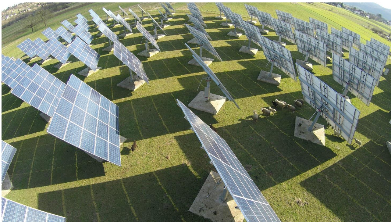
Slika 4: Obstoječa fotonapetostna naprava investitorja Vrata Deržič, Rudolf Deržič s.p. s sledilnim sistemom, ki ga je razvil in proizvedel investitor sam (vir: Vrata Deržič)
