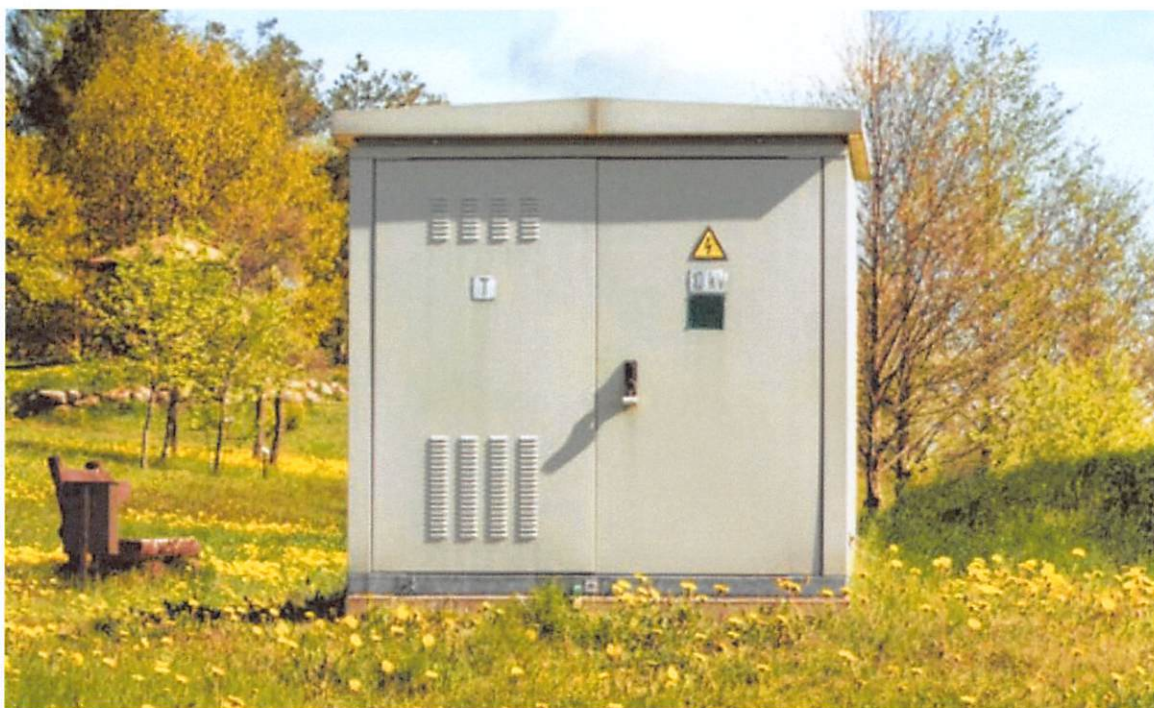
Slika 11: Primer izvedbe tipske transformatorske postaje
